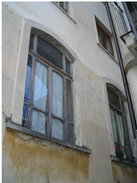
Foto n° 3 - Particolare serramenti da sostituire
